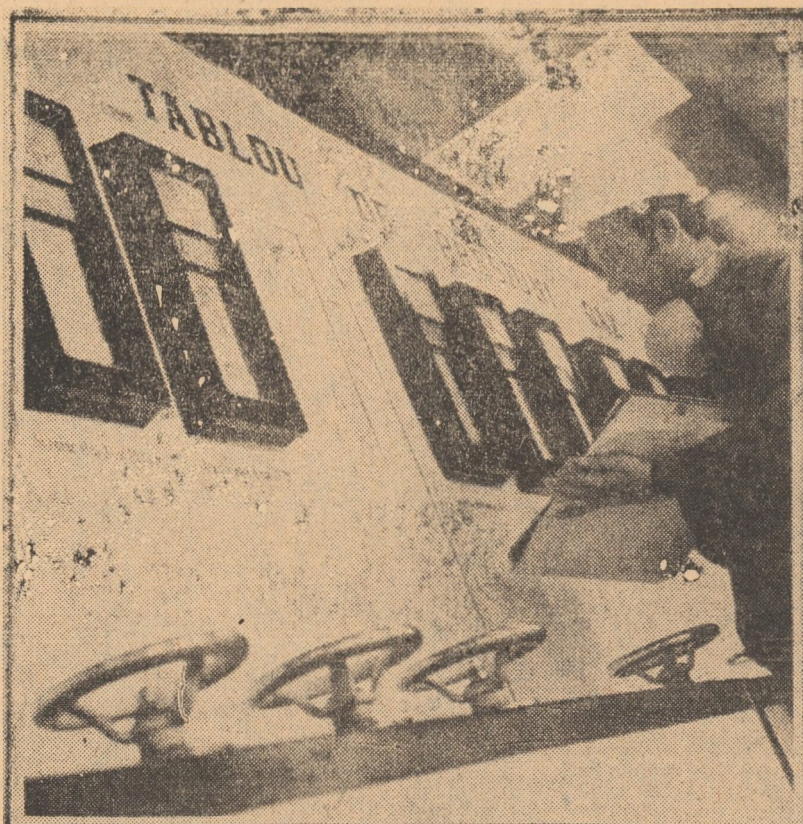
U.M.M.N. Copșa Mică. Panoul de comandă al instalației de rafinare termică a zincului. De aici se comandă la distanță combustionarea instalației
