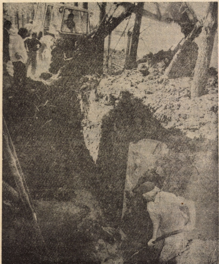
Înteruperea furnizării apei reci în câteva cartiere din Sibiu a fost determinată de spargerea conductei (cu diametrul 1000 mm) care face legătura între instalația de filtrare și rezervoarele de clorinare (dezinfecție) a apei. Responsabilul lucrării, ing. Forir Nicolae speră că în maximum 24 de ore de la începerea lucrării, reparația să fie efectuată. Foto: A. BUTA
